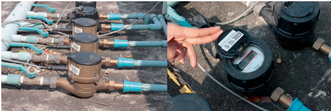
รูปที่ 81 ตัวอย่างการติดตั้งมาตรวัดน้ำย่อยแบบ digital แยกการใช้น้ำรายประเภท
