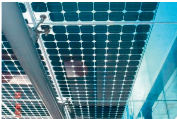
รูปที่ 86 การใช้ PV glass เป็น skylight และผลิตไฟฟ้าในขณะเดียวกัน
