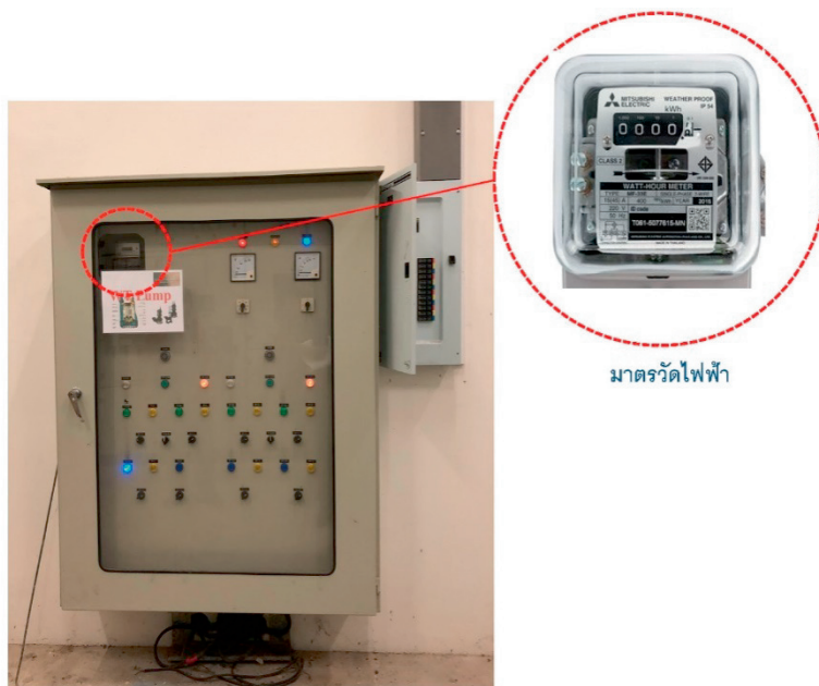
รูปที่ 73 ตัวอย่างการติดตั้งมาตรวัดไฟฟ้าของระบบบำบัดน้ำเสีย
